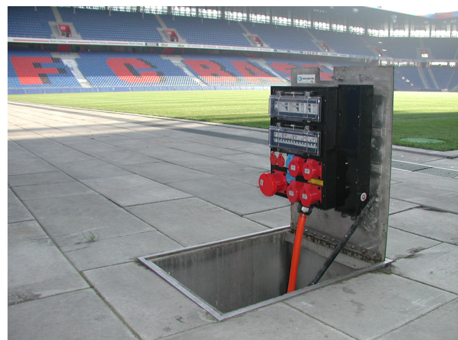
Distribution électrique souterraine, Parc St-Jacques, Bâle
