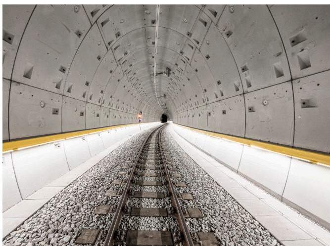
LaneLED GFK, tunnel Glatscheras
